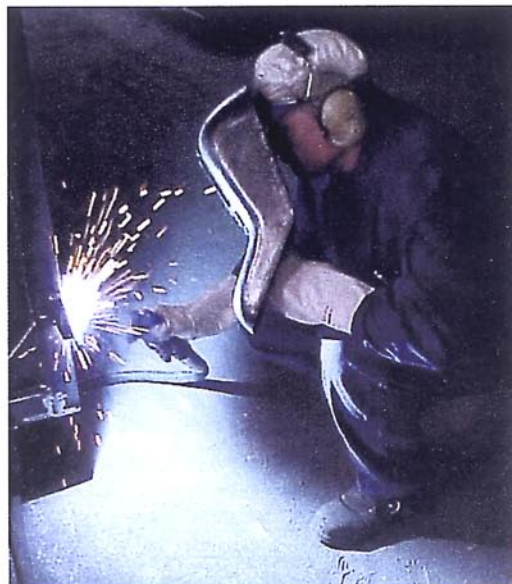
Bild 2. Schweißen kein Problem: Auch extremer Dauerfrost kann den chemisch verdichteten Betonböden nichts anhaben (Fotos: Norsa)
