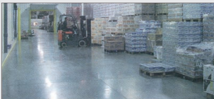
Bild 2. Der Boden ist resistent gegen die meisten Flüssigkeiten und Verunreinigungen (Fotos: Norsa)
